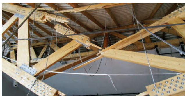
Zniszczenia konstrukcji dachu. Fot. PINB
