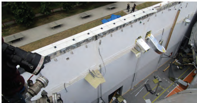
Zniszczenia konstrukcji dachu. Fot. PINB
