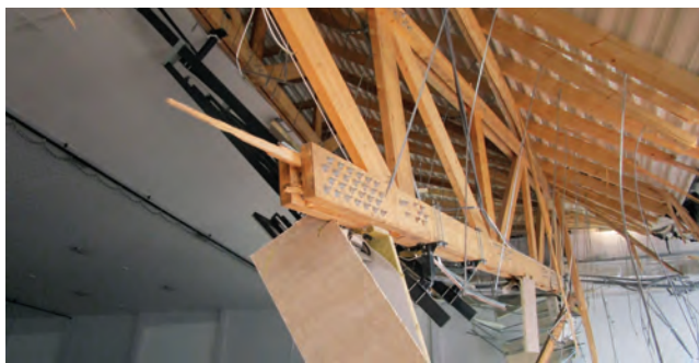
Zniszczenia konstrukcji dachu. Fot. PINB
