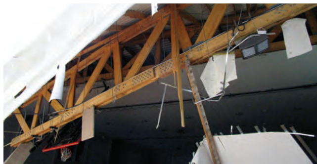
Zniszczenia konstrukcji dachu. Fot. PINB
