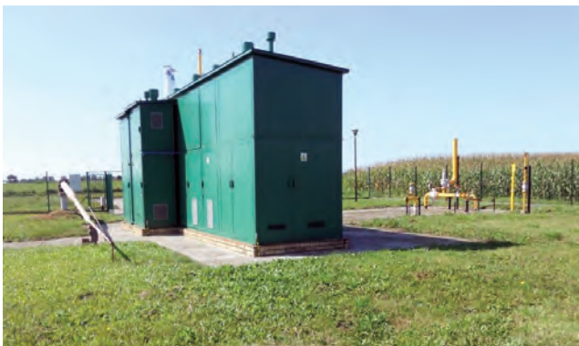
Rys. 1. Przykładowa lokalizacja nawianialni (przy ścianie obudowy stacji redukcyjnej) [5]
