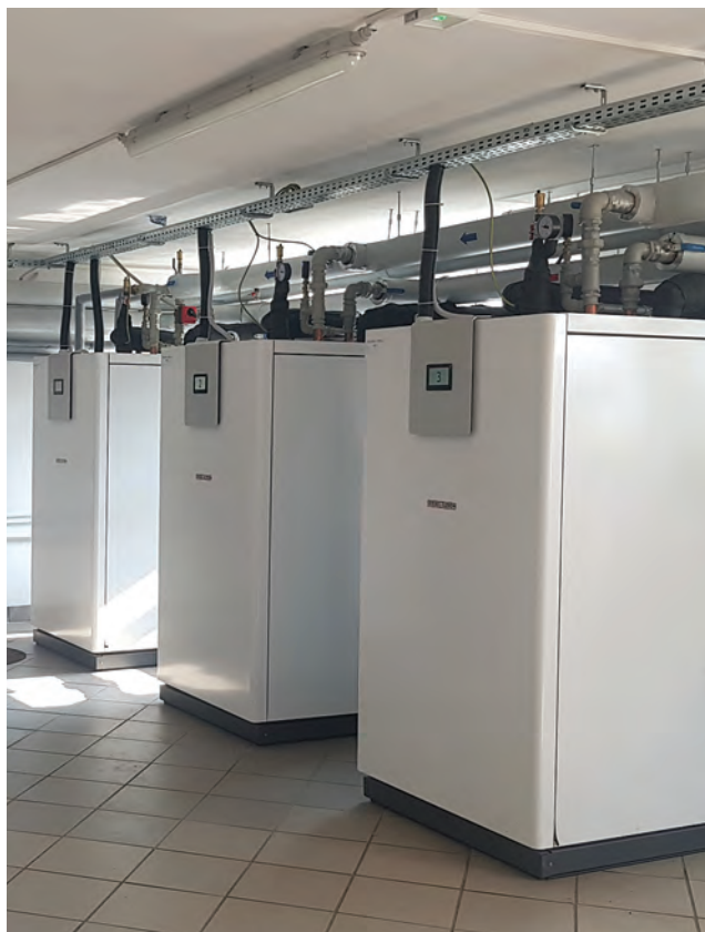
Ryc. 7. Kaskadowy układ pomp ciepła zasilanych z pionowego gruntowego wymiennika ciepła. Fot. WA
